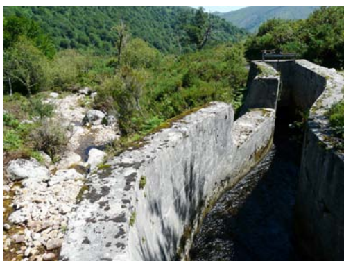
Captación en el Bco de la Yunca- Joyoprao (Rionansa)
