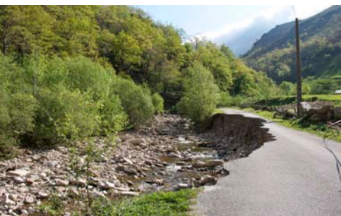
La carretera de Pandillo (Vega de Pas), tras los desperfectos producidos por la riada del Pas (marzo 2012)
